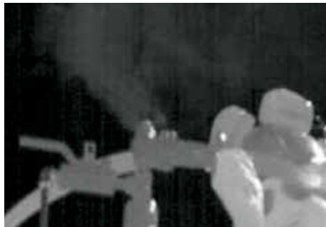
La termografía con la GF306 puede detectar fugas de \text{SF}_6 de tuberías y disyuntores.
